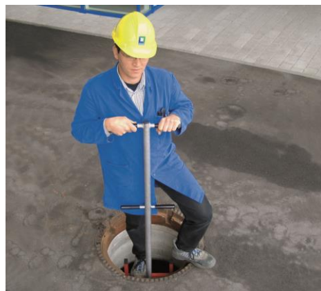
1 Descente dans un puits avec l'aide d'un support
